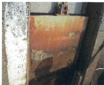
写真 3-2 扉体の発錆及び腐食状況
