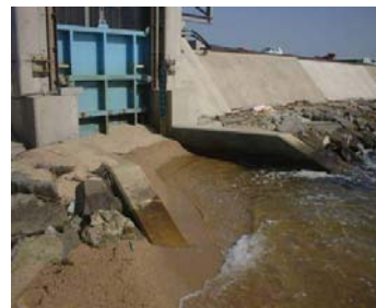
写真 3-3 排水門吐口付近の土砂堆積状況
