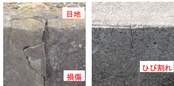
写真-4 水路の損傷状況（左：目地、右：側面）
