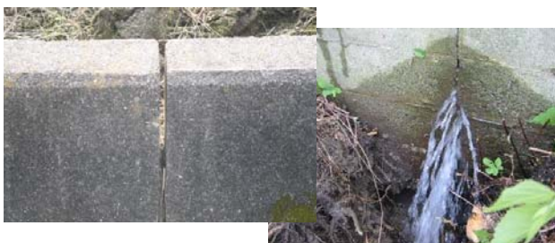
Fig.1 目地材の欠損と目地部からの漏水
