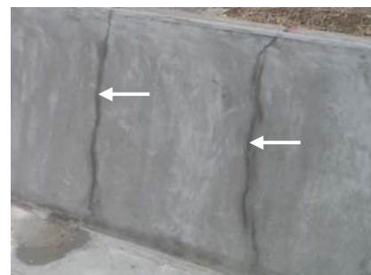
図-1 既往の補修材料の早期ひび割れ
