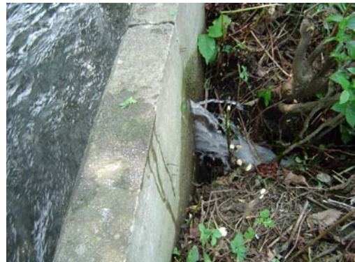
Fig.1 水路目地部からの漏水 Water leakage at joint part of canal
