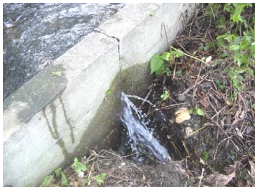
写真-1 目地損傷部からの漏水
