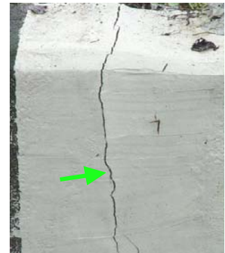
写真-2 目地補修部に発生したひび割れ
